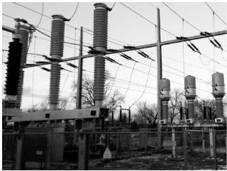
图8 运行中的户外 145 kV 柱式真空断路器 Fig. 8 145 kV outdoor LT with VIU
