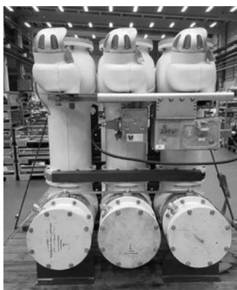
图2 245 kV GIS母线转移电流试品
